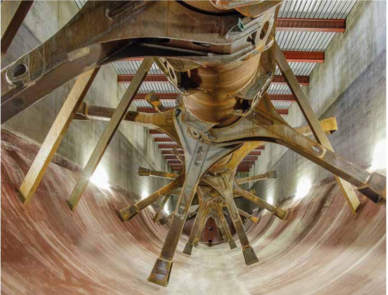
Interno del digestore a secco (TTV).
